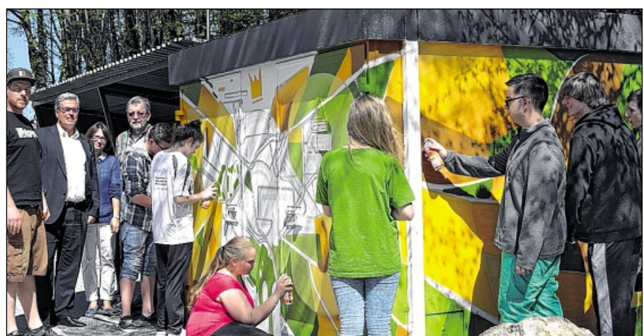
In ein Schmuckstück haben Acht- und Neuntklässler der Gondelsheimer Kraichgauerschule die alte Trafostation auf dem Schulgelände verwandelt. Foto: pr
